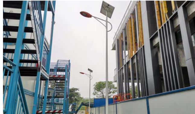
广州创智园项目 - 太阳能路灯
