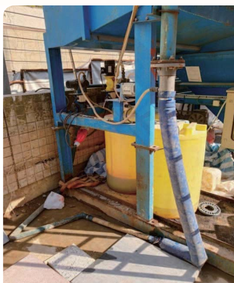
集中淨化污水
