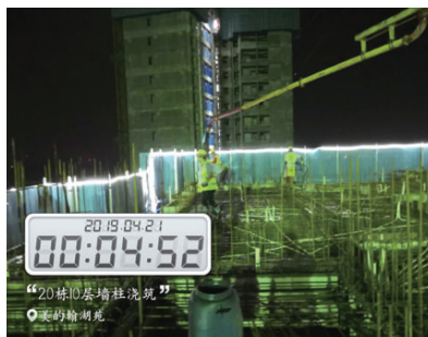
爬架外圍LED燈帶，提供夜間施工照明
