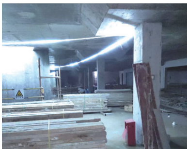
佈置在通道兩側的地下室的LED燈帶
