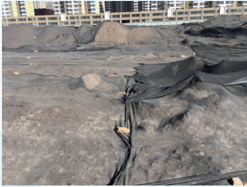
建築工地中設有裸土覆蓋
