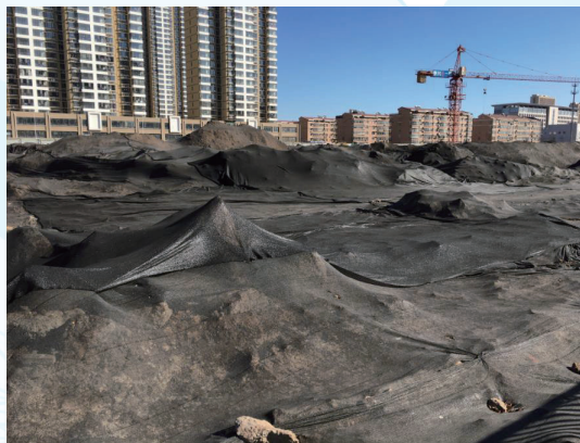
建築工地中設有裸土覆蓋
