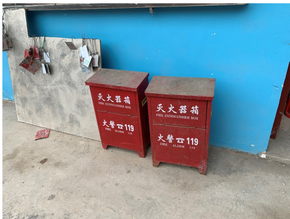
▲礦區內設置消防設備
