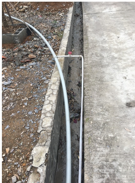
▲水管用作處理用水分流
