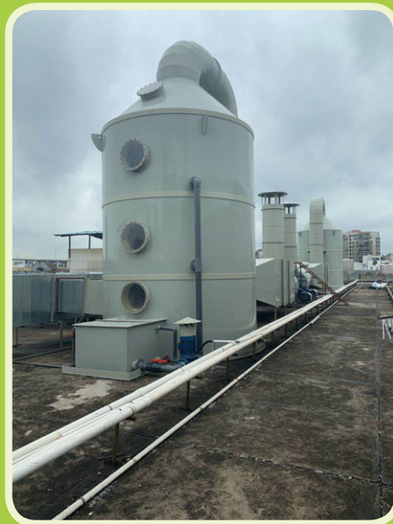
揮發性有機化合物及廢氣處理設備
