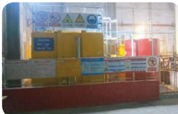
脫硫酸鹼系統增設鹼罐及卸鹼泵
