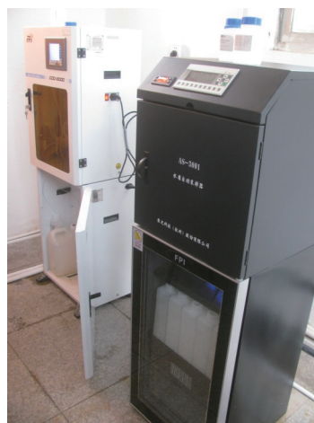
廢水處理監控系統
