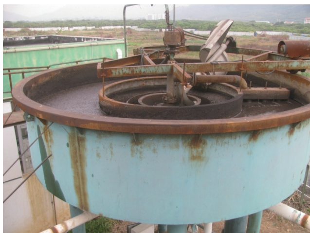
廢水過濾及處理系統
