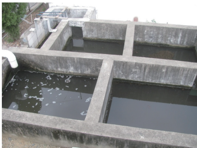
廢水過濾及處理系統
