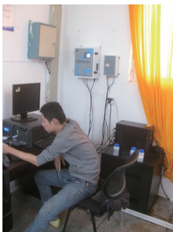
廢水處理監控系統
