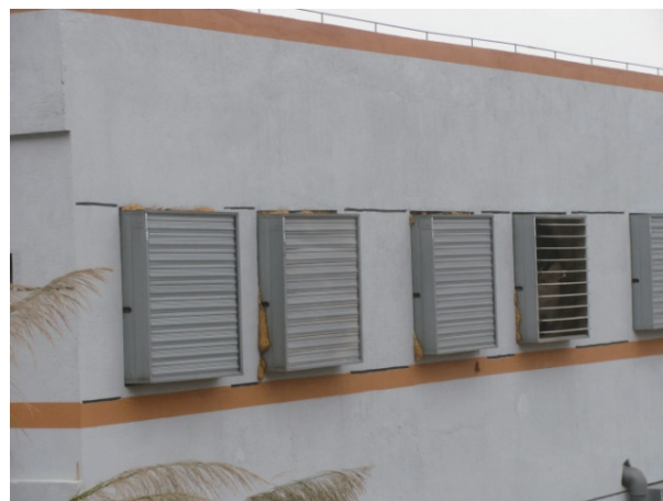
養豬欄排氣扇
