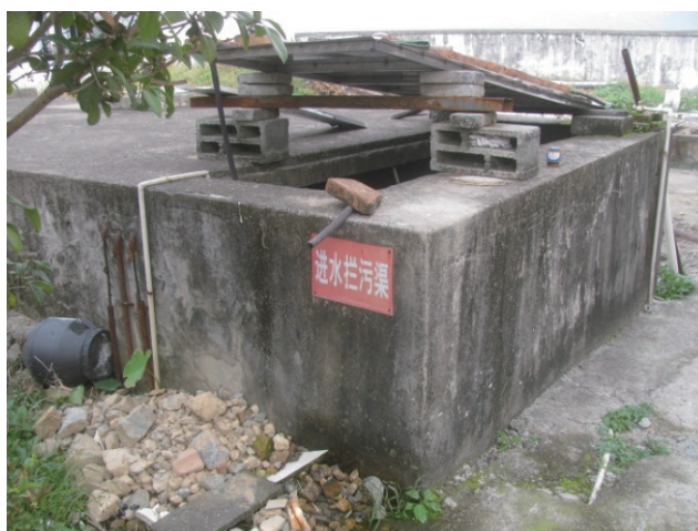
廢水過濾及處理系統
