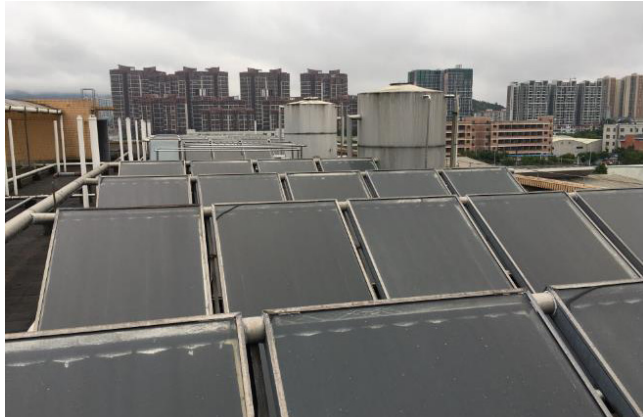
員工宿舍天台上的太陽能發電設備
