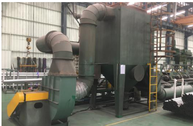
生產廠房中設有脈衝式濾袋集塵機
