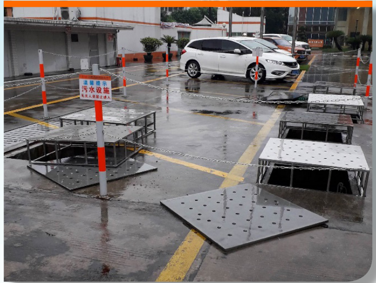
上圖為污水沉澱池(左)和污水設施(右)。
