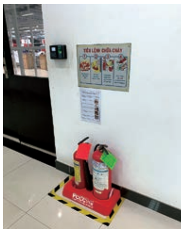
放置在廠房的滅火器及標語
