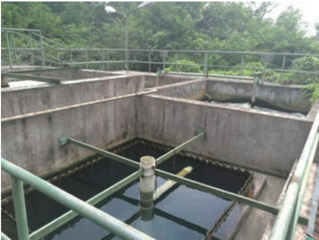
中山同得仕的污水處理設施
