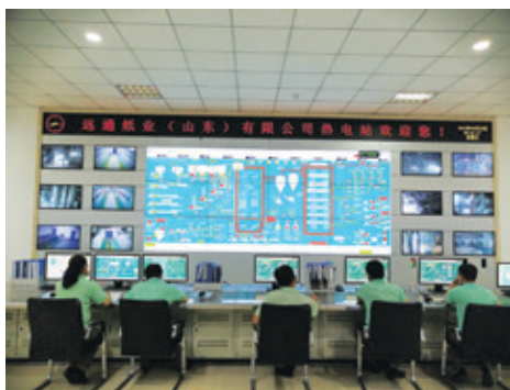
熱電站主控室
