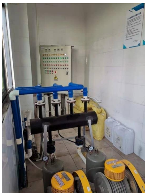
新海南佳寧娜食品廠 - 污水處理設施
