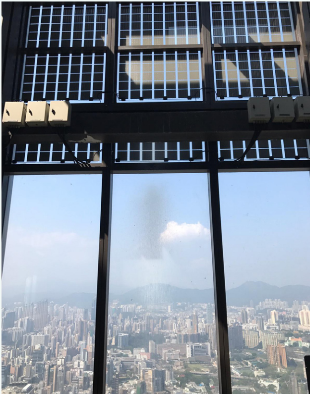
香港最大型的混合光伏及內置外牆光伏太陽能系統之一
