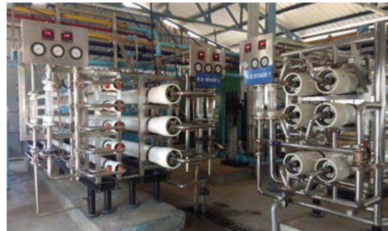
先進三級水處理廠，令廢水得以循環再用
