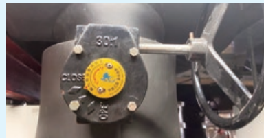
調整冷凍水循環泵出口閥門開度，降低水泵運行電流
