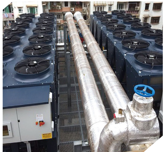
磁浮壓縮機中央冷氣系統
