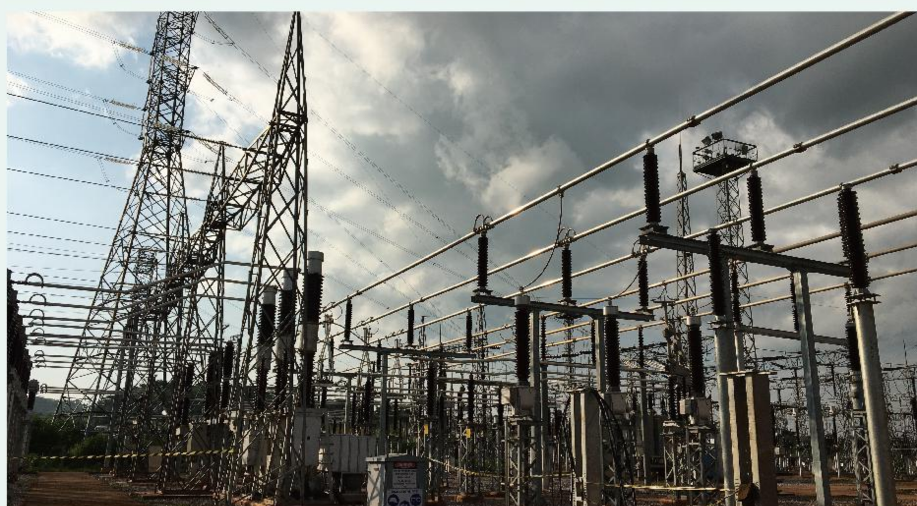
丰古鲁美供电站建成后，将覆盖25万人口的用电需求
