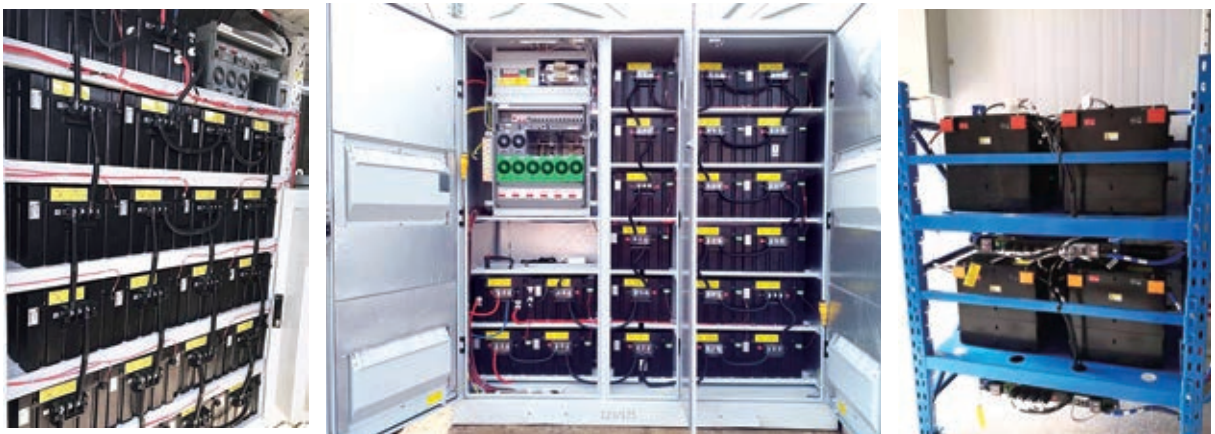
▲ 基站動力電池梯次利用現場
