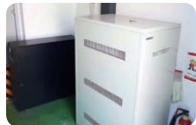
▲ 備電、監控、發電設備放置現場
