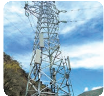
▲使用電力塔掛載移動網絡天線
