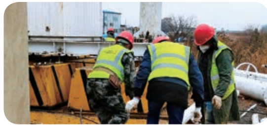
▲ 武漢火神山醫院發電保障
