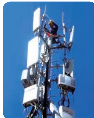
▲ 鐵塔上放置物聯網採集設備
