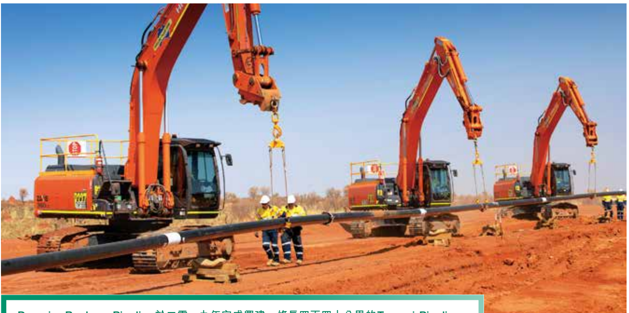
Dampier Bunbury Pipeline 於二零一九年完成興建一條長四百四十公里的 Tanami Pipeline。
