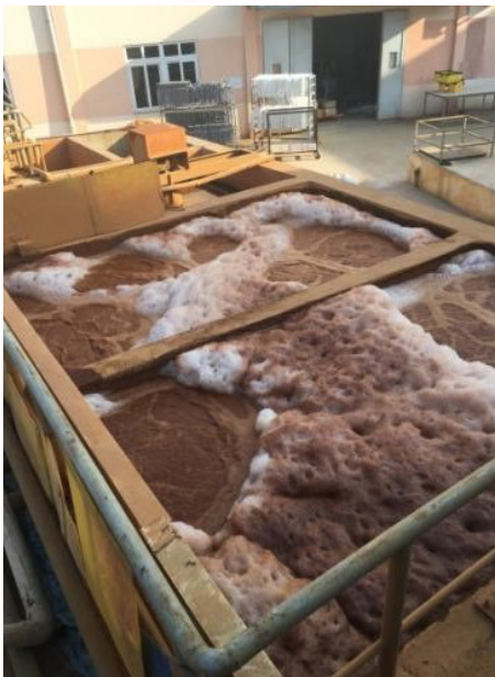
J.Y. Plasteel 透過微生物處理生活污水
