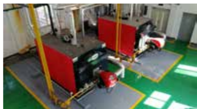
改造后的锅炉
