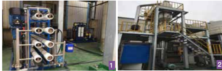
1. CFRO膜浓缩系统 2. MVR废水强制循环蒸发器
