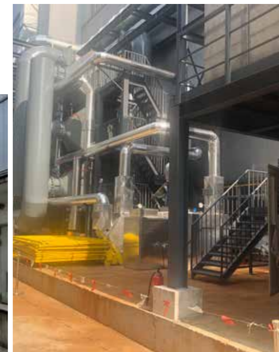
改造后喷漆房治理设施
