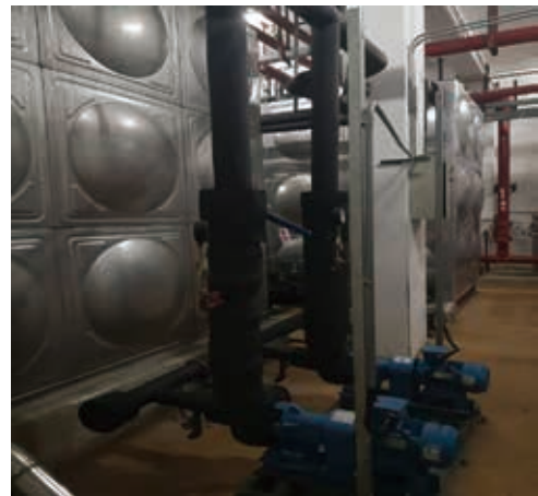
空調餘熱回收管道及循環泵設備
