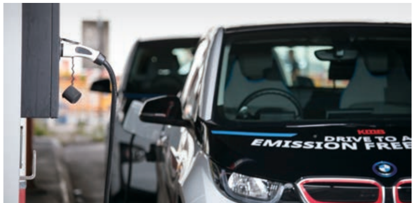
○ 九巴及龍運於主要車廠設置電動巡邏車充電系統
