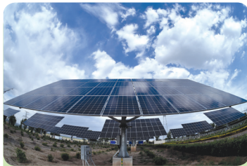
大同二期的「領跑者」光伏發電項目
