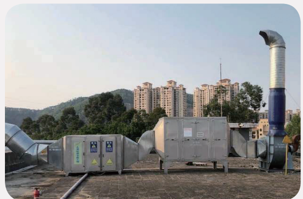
Exhaust air treatment system 廢氣處理系統
