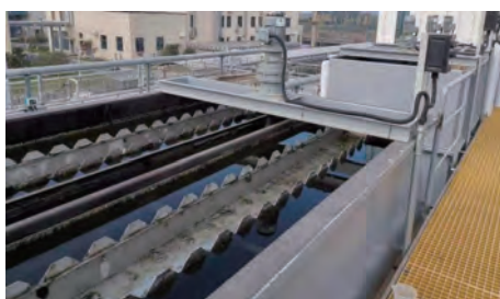
無錫基地污水處理站
