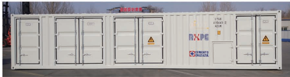
集裝箱式變電站
