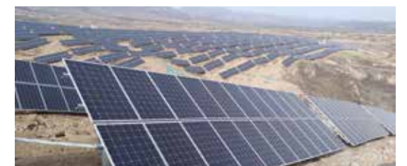
山西省太原市陽曲縣楊興鄉光伏扶貧電站
