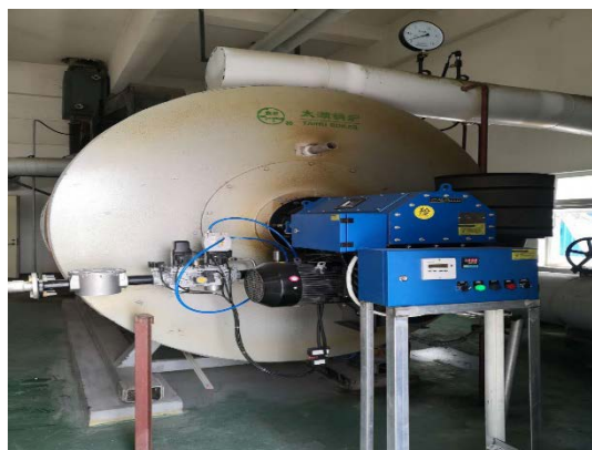
蚌埠食品廠鍋爐改造
