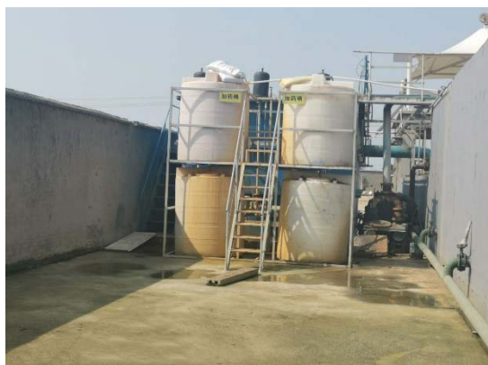
蚌埠肉品廠污水處理設備
