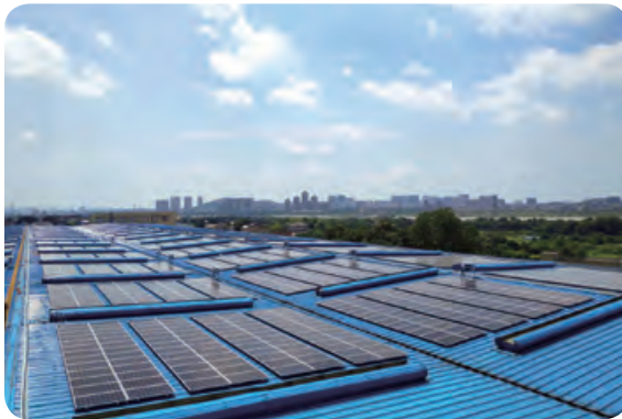
湖南省湘電屋頂分佈式光伏項目
