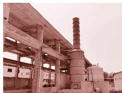
酸霧吸收淨化塔
