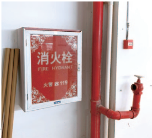
工廠內的消防設備
