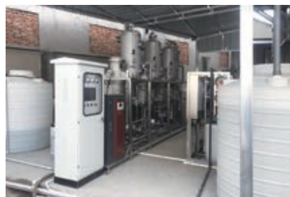
工業污水集中處理後，循環用水
