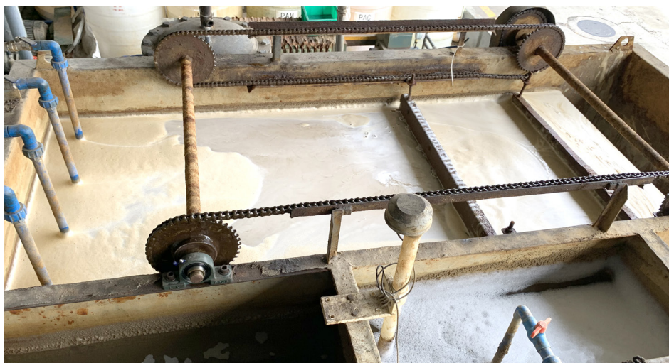
污水處理系統
