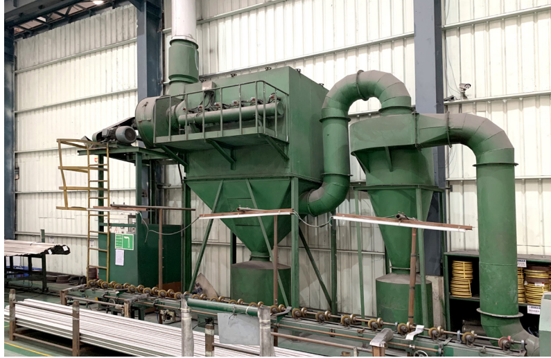
生產廠房中設有布袋除塵器
