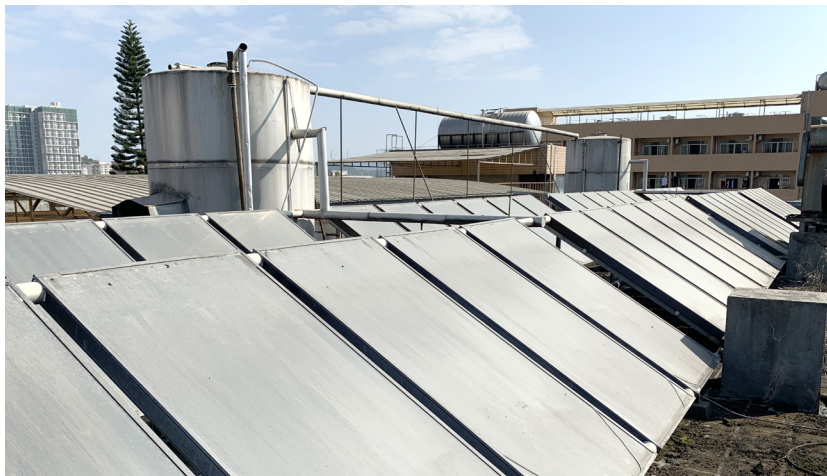
員工宿舍天台上的太陽能發電設備
