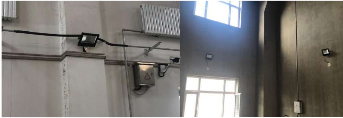
圖 22：牡丹江污水處理廠污泥處置項目的節能照明系統。
