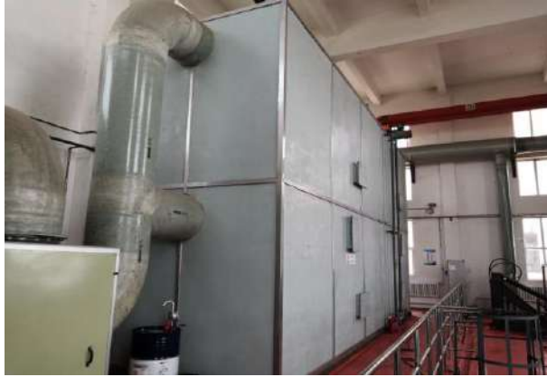
圖 11：佳木斯市污水處理廠污泥處置項目生物除臭設備。
