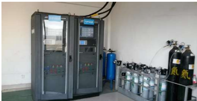
圖 13：達州市城市生活垃圾焚燒發電項目一階段的煙氣在線監測系統。
