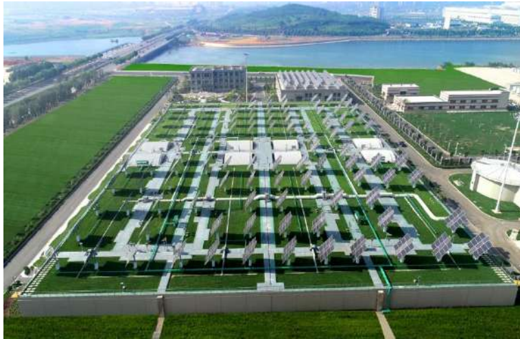
圖 15：大連泉水河污水處理廠（二期）項目安裝的太陽能電池板。
