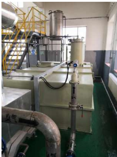
圖 10：佳木斯市污水處理廠污泥處置項目的化學除臭設備。
