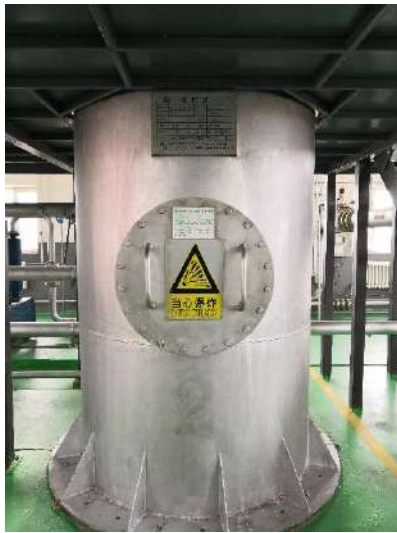
圖 9：佳木斯市污水處理廠污泥處置項目的脫硫設備。
