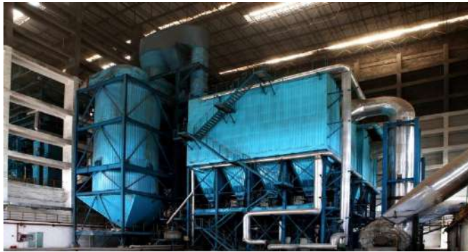
圖 12：達州市城市生活垃圾焚燒發電項目一階段的煙氣淨化系統。
