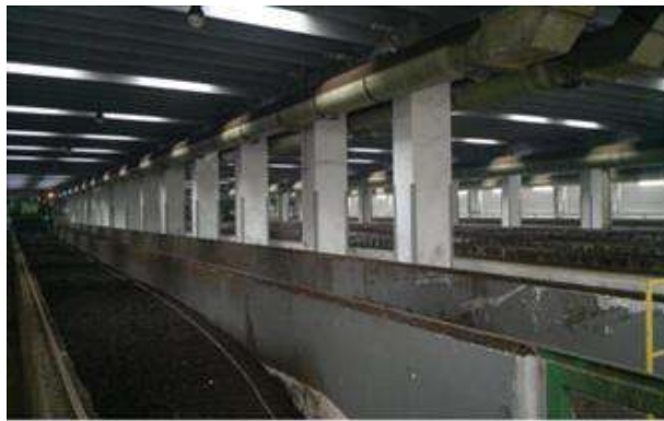
圖 20：新鄉市污泥處理處置項目高溫好氧發酵車間。
