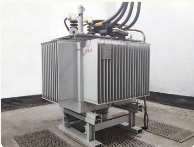
油浸式變壓器
