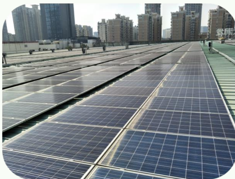
屋顶光伏项目
