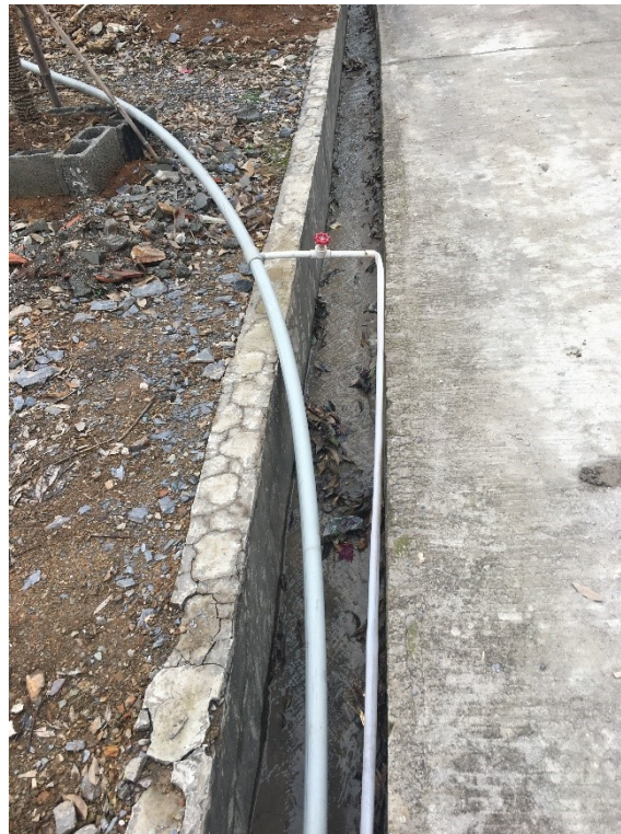
▲水管用作處理用水分流
