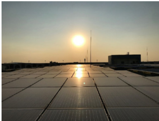
深圳機場物流園區屋頂光伏發電站
