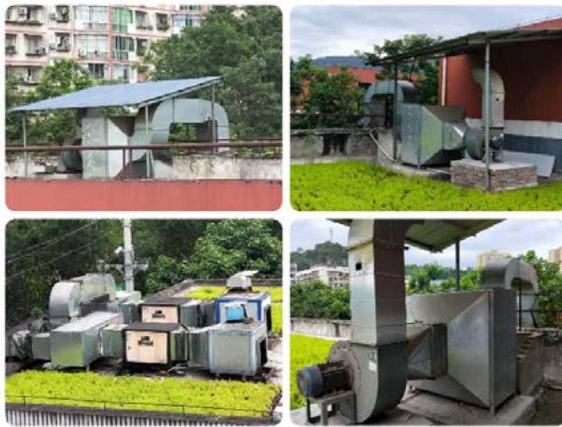
萬州廠房內設置的廢氣處理設備
