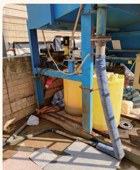
集中淨化污水
