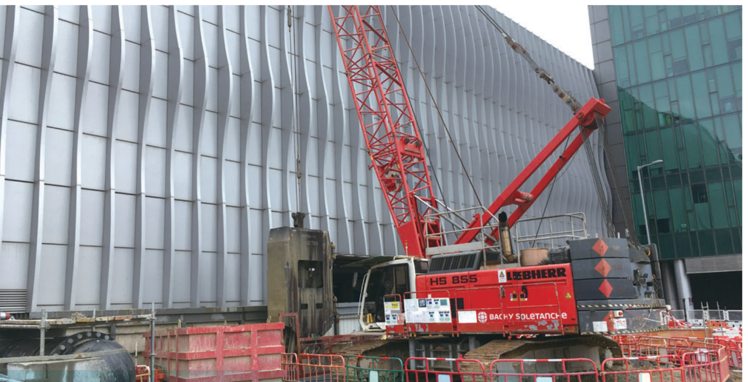
Hong Kong International Airport — Terminal 2 Foundation and Substructure Works 香港國際機場 — 二號客運大樓地基及下層結構工程
