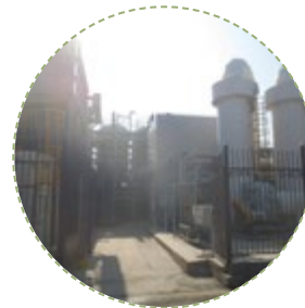
氨氮廢水處理設施
