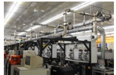
廢氣收集管道
