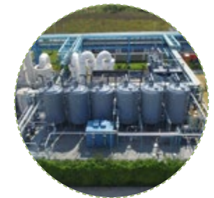
廢水回用處理設施
