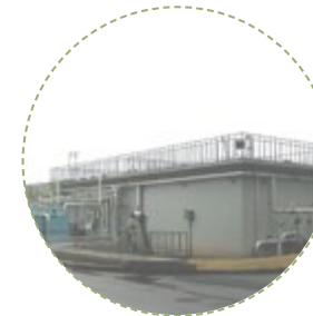
生活污水處理設施
