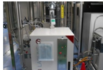
廢氣本地處理設備
