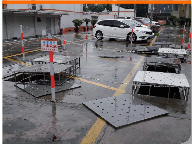
上圖為污水沉澱池(左)和污水設施(右)。
