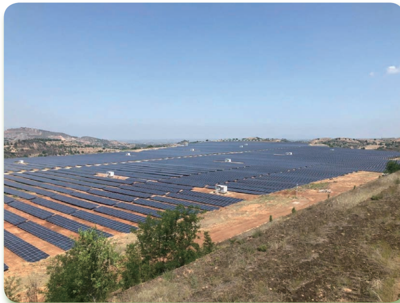
▲ 晉能方山光伏發電站
