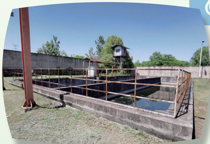
Sewage treatment facilities at LPG storage tank farm of Minsheng Gas 位於民生石油的液化石油氣儲庫基地之污水處理設施
