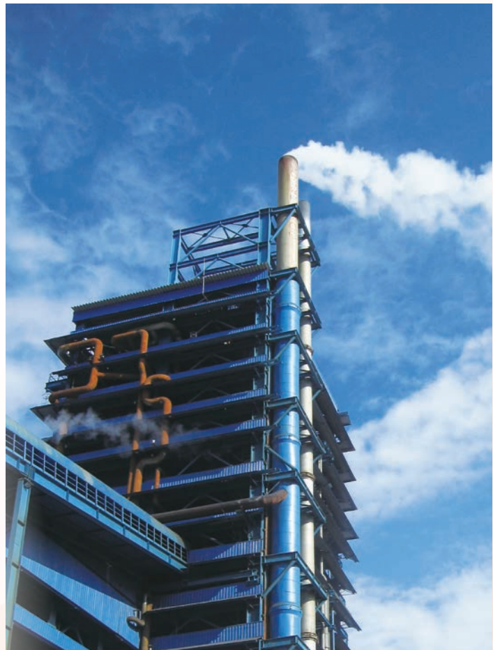
銅冶煉公司ISA爐廠房
