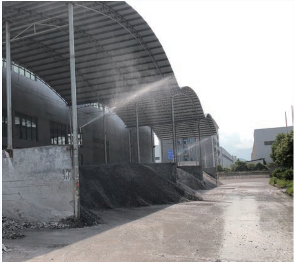
圖1：長沙麓谷二廠的噴霧降塵裝置
