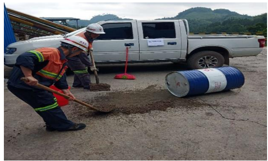
贵州紫金废机油转移泄露应急处置
